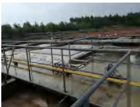
废水处理设施
