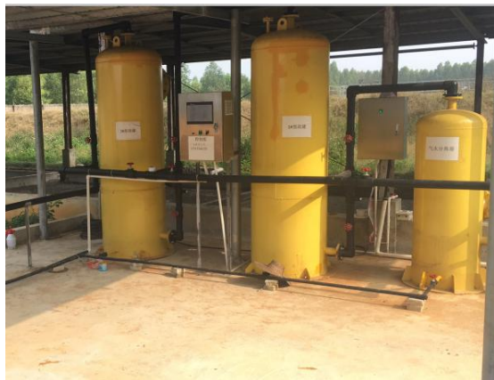
沼气管脱硫设施
