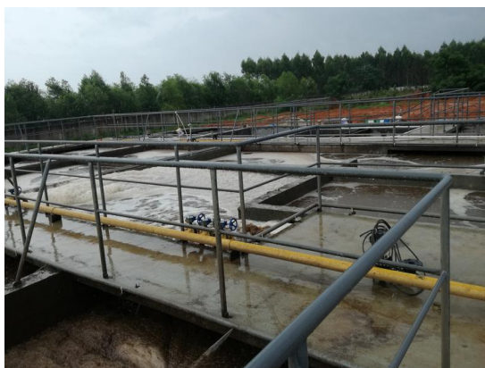
废水处理设施
