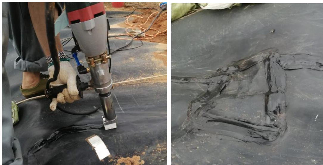
图 2.1-3 沼气池修补照片
