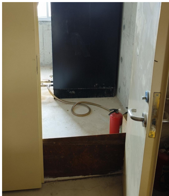
柴油储罐（含围堰）
