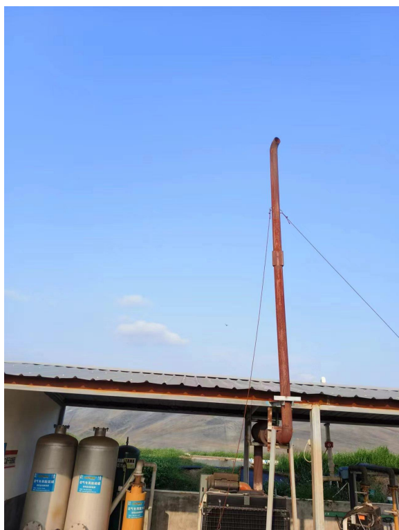
沼气发电机排气筒
