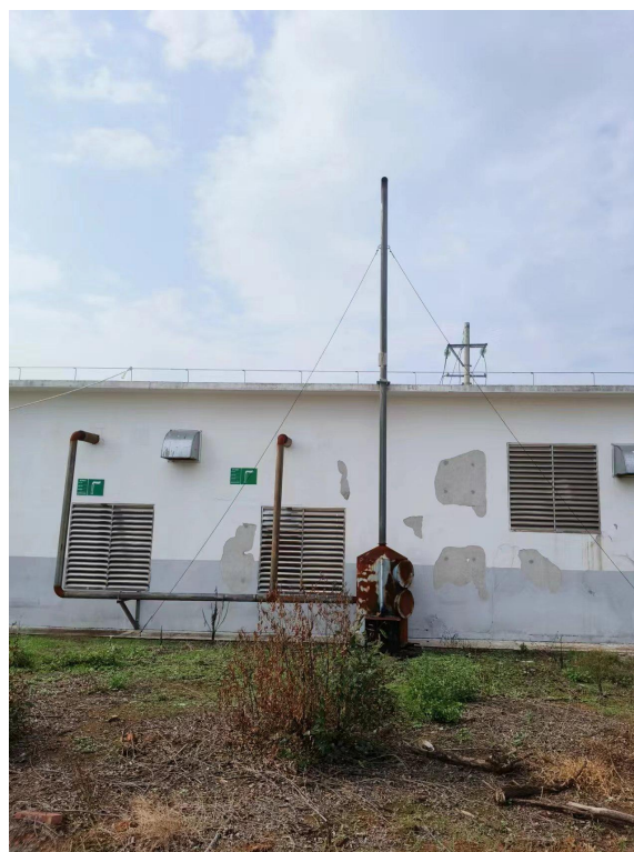
柴油发电机排气筒
