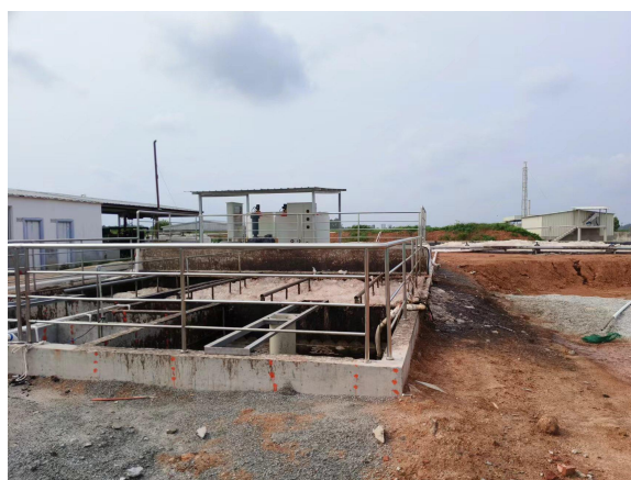
污水处理设施
