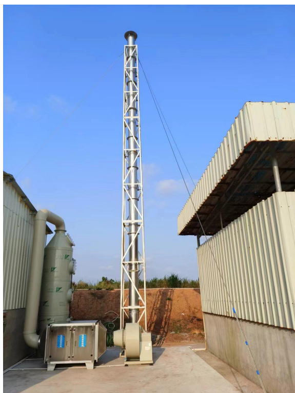
堆粪间排气筒
